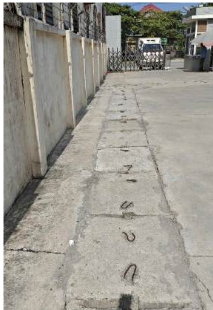
Hình 3. 3. Cống thu gom nước mưa
