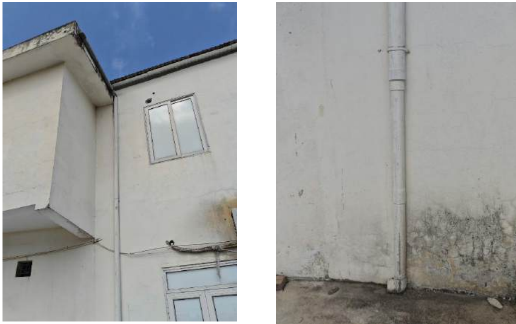
Hình 3. 2. Đường ống dẫn nước mưa từ mái nhà
